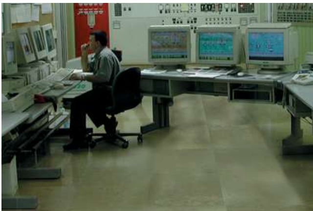
Sala de Control de Proceso de planta Alcanar.
