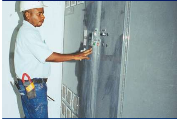
Variador de frecuencia.
